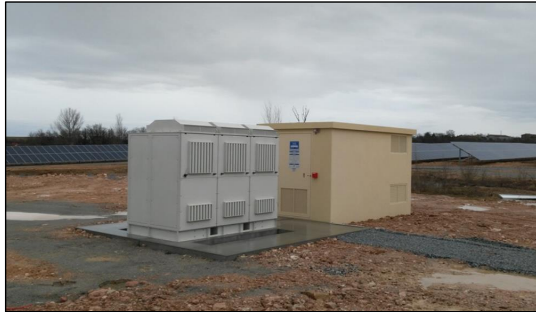
Illustration 15 : Exemple de poste de transformation et d'onduleur « outdoor » (Source : Arkolia Energies)
