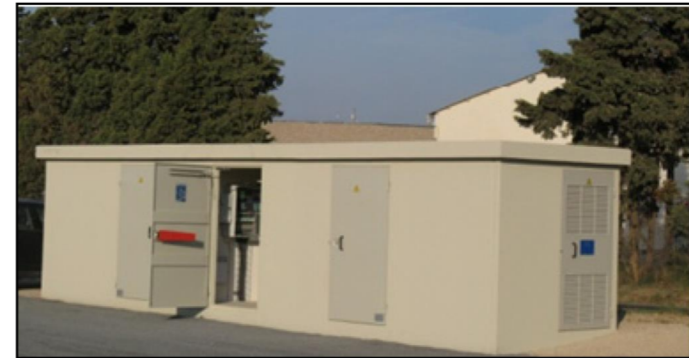
Illustration 14 : Exemple de poste de livraison (Source : Arkolia Energies)
